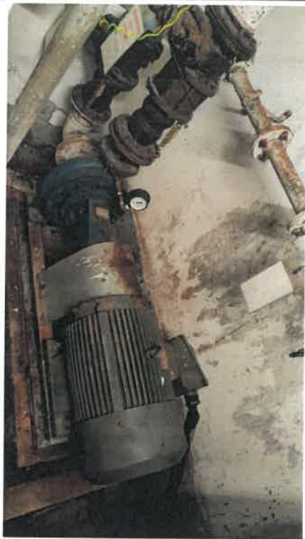
地下消防泵房加壓泵
