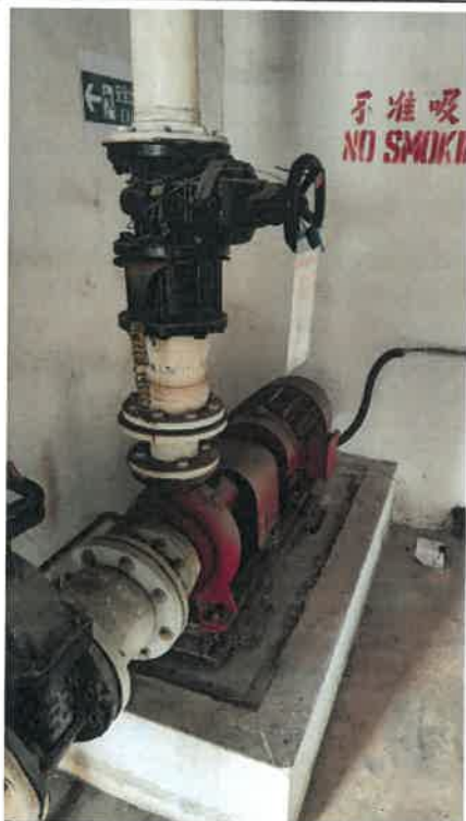
天台消防泵房加壓泵
