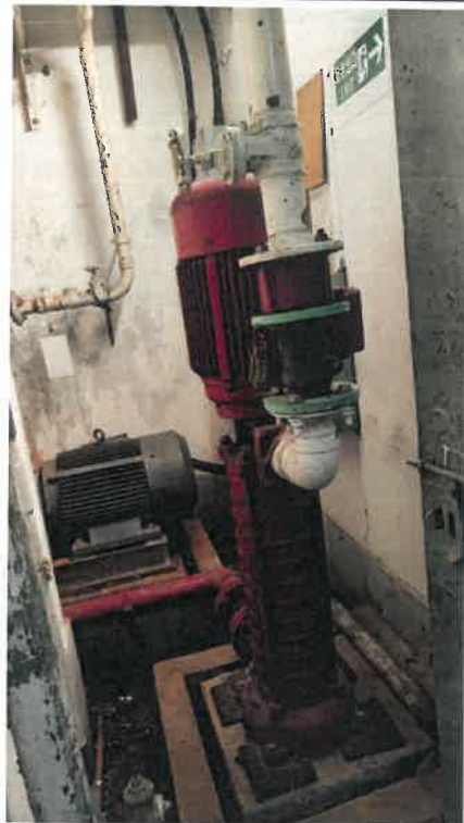
地下消防泵房上水泵
